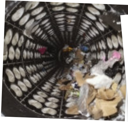
Séparation des emballages par taille dans le « trommel »
